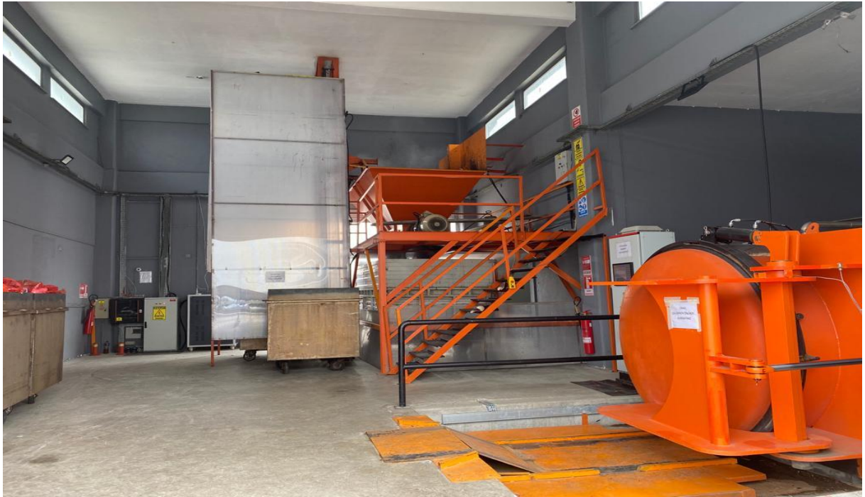
Tıbbi Atık Sterilizasyon Ünitesi
