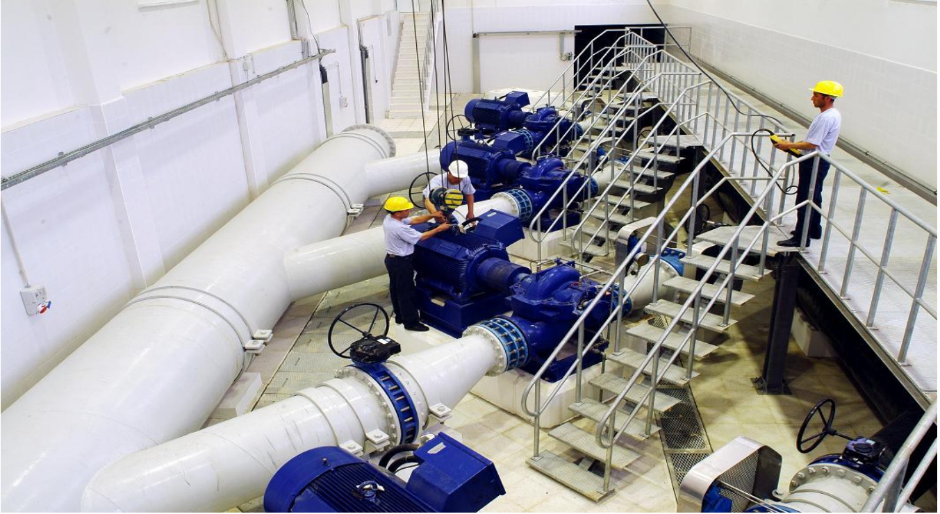
Çatalan Arıtma Tesisleri Pompa Odasından bir görünüm
