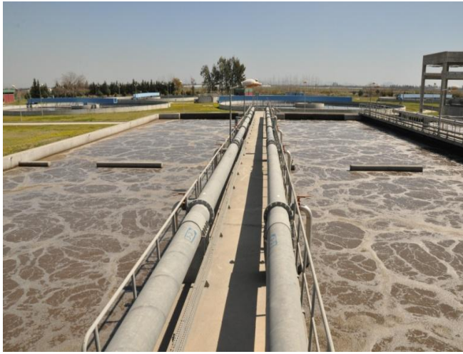
Seyhan Atıksu Arıtma Tesisi havalandırma havuzu
