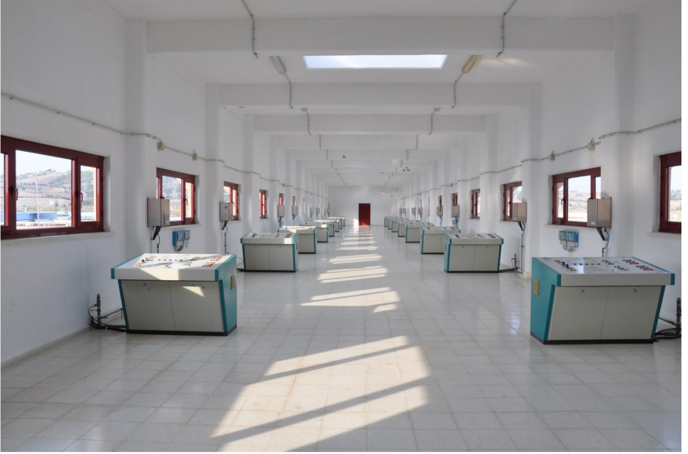
Çatalan İçmesu Arıtma Tesisi filtre kumanda odasından bir görünüm.
