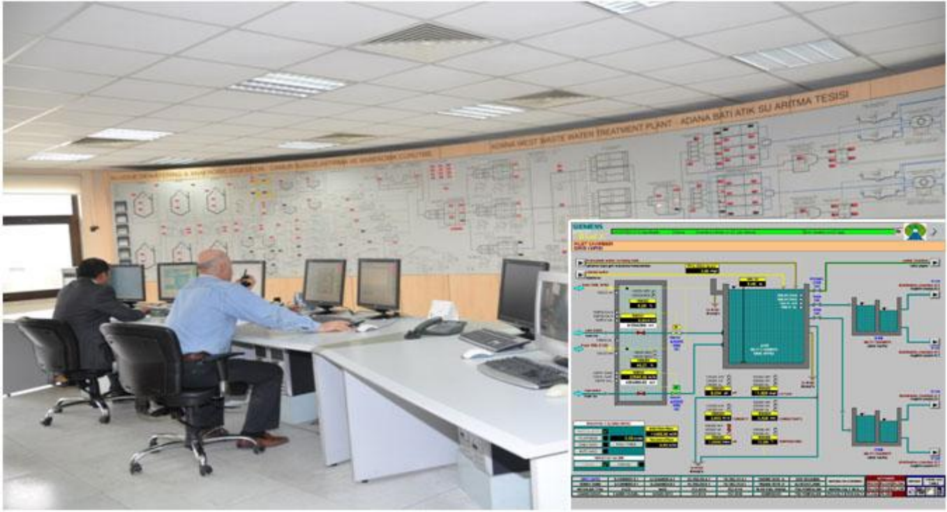
Seyhan Atıksu Arıtma Tesisi SCADA ve otomasyon sisteminden bir görünüm.
