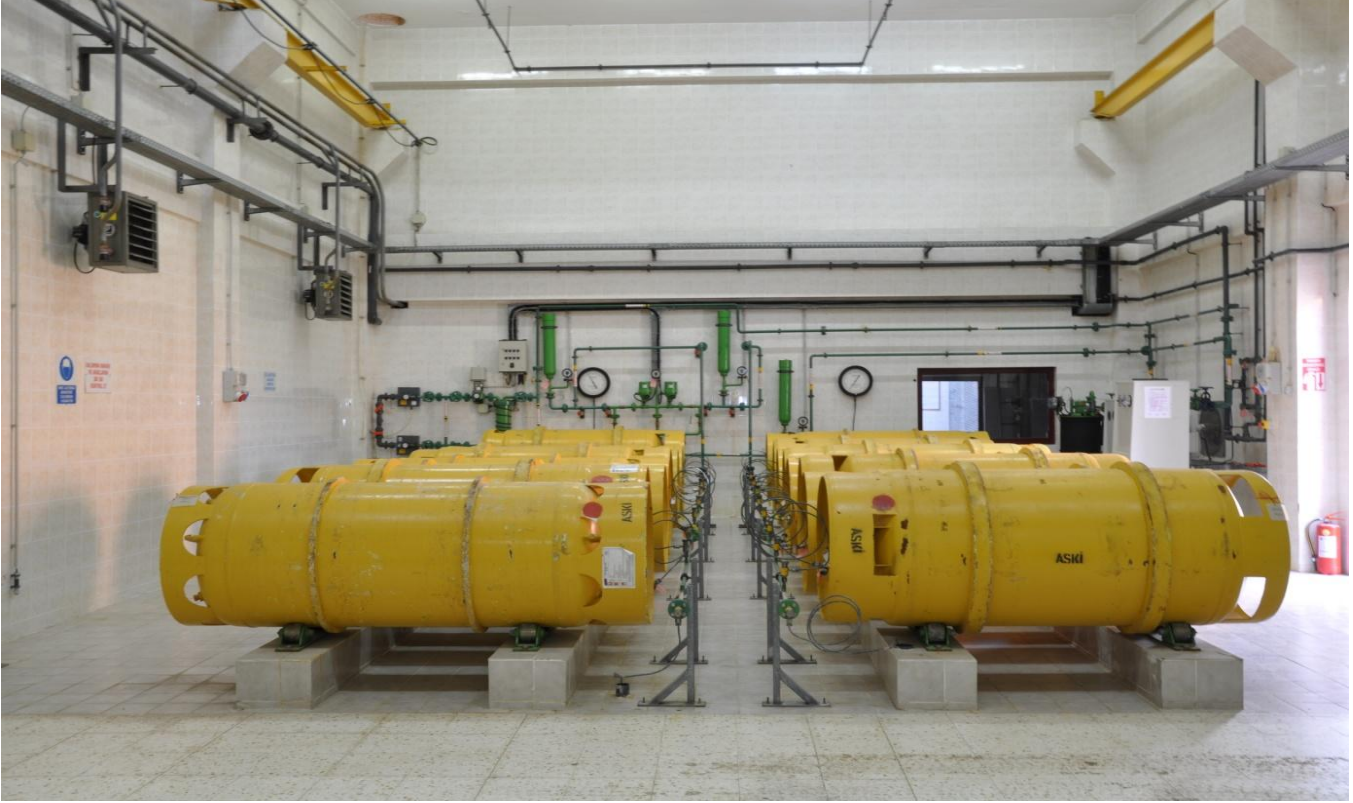
İçmesu Arıtma Tesisleri Klorlama Odasından bir görünüm.
