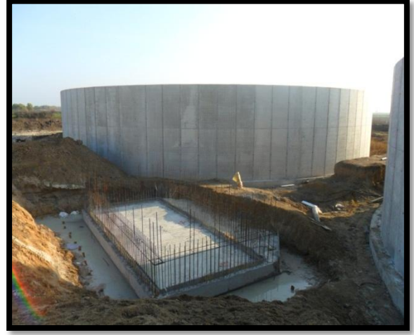
Geri Devir ve Fazla Çamur Pompa İstasyonu
