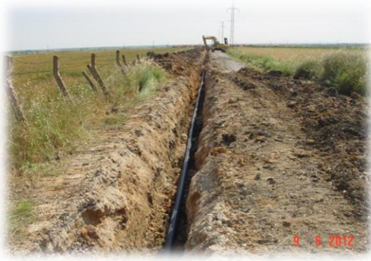
L.M.Y.O İÇMESUYU HATTI
