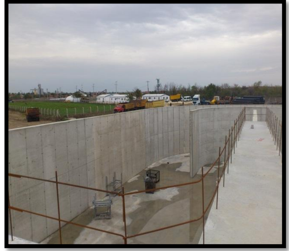
Son Çöktürme Havuzu Üst Görüntüsü
