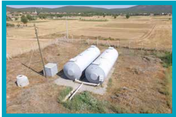
Horasanlı Paket Atıksu Arıtma Tesisi
