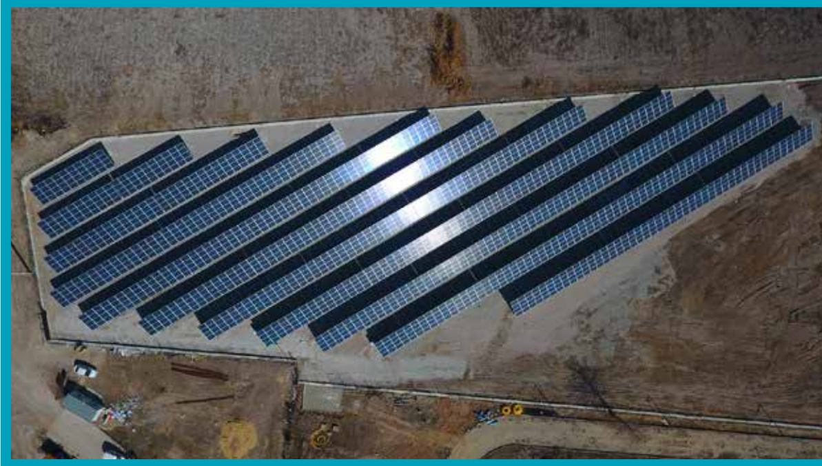
Güneş Enerji Santrali
