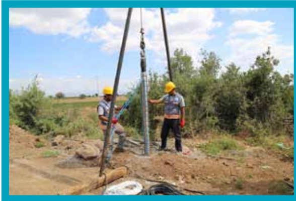
Pompa İndirme İşlemi
