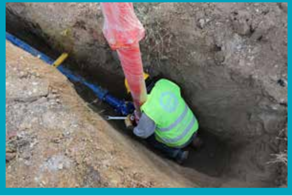
Cumhuriyet Mahallesi Yangın Hidrantı Bağlantısı
