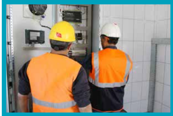
Elektrik Pano Arızası
