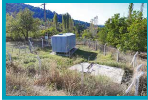
Hayriye Paket Atıksu Arıtma Tesisi
