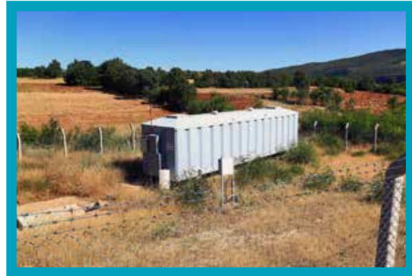
Çoğuşlı Paket Atıksu Arıtma Tesisi
