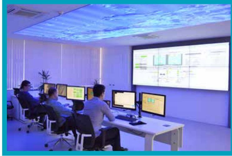
DESKİ - SCADA Kontrol ve İzleme Odası
