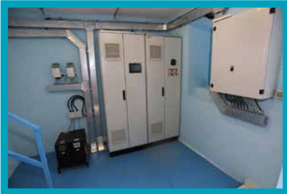
İçmesuyu Deposu Kontrol Paneli
