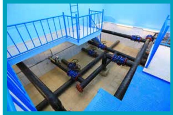
Servergazi İçmesuyu Deposu Manevra Odası
