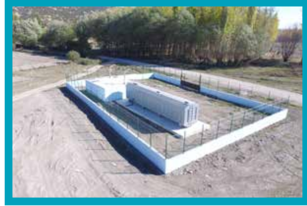
Çivril Beydilli Paket Atıksu Arıtma Tesisi
