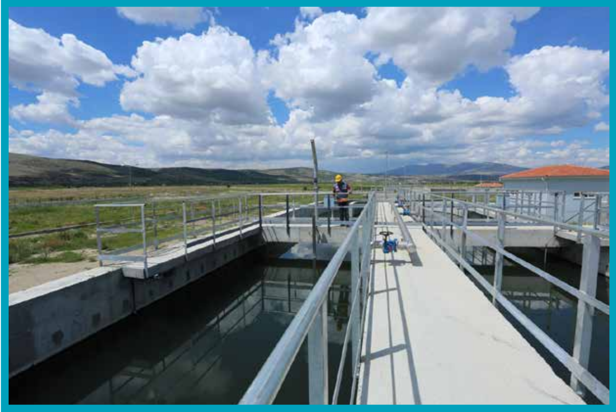
Çivril Atıksu Arıtma Tesisi
