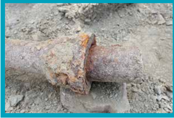
Honaz İlçesi Haydar ve Yenimahalleleri Eski İçmesuyu Hattı
