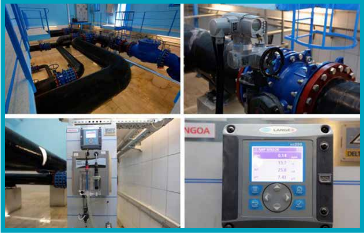
Bereketli Mahallesi SCADA Kontrollü Su Depolarımız
