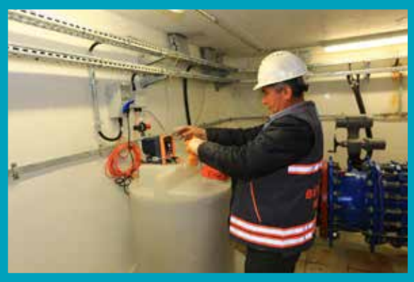
İçmesuyu Deposunda Klor Dozaj Pompası Ayar Çalışması
