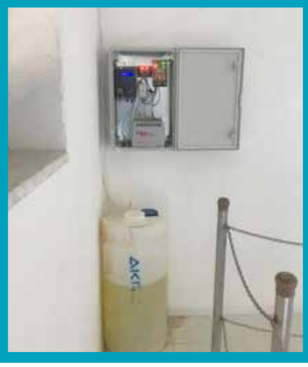
Çal Alfaklar Klor Dozaj Pompası Kurulumu
