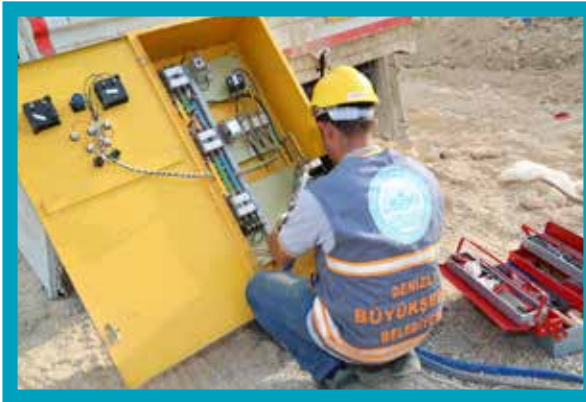
Elektrik Pano Arızası
