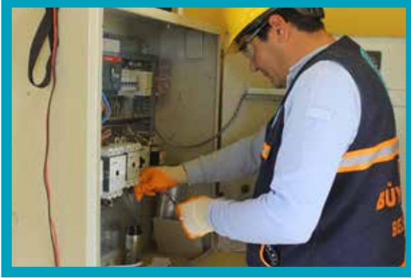
İçmesuyu Pompalarının Kompanzasyon Takibi İşİ
