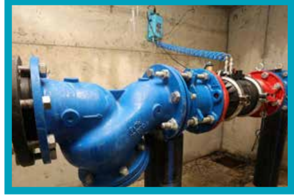
Kuşpınar Mahallesi İzole Bölge İçmesuyu Vana Odası Ekipmanları
