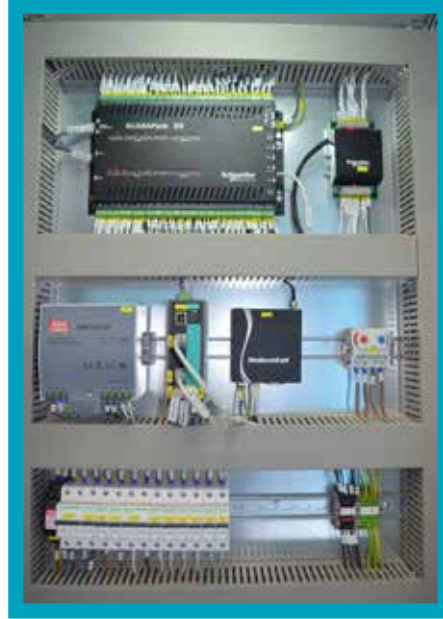
SCADA Elektrik ve Otomasyon Panosu
