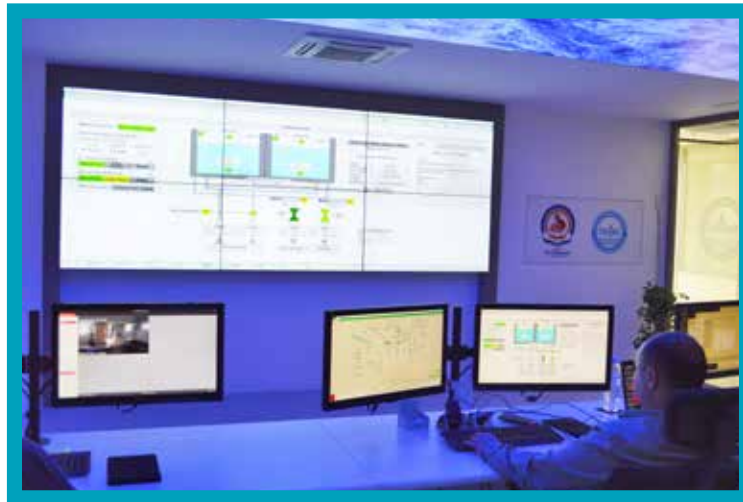
DESKİ - SCADA Kontrol ve İzleme Odası
