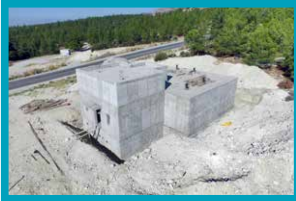
Pamukkale İlçesi Irlıanlı Mahallesi İçmesuyu Deposu
