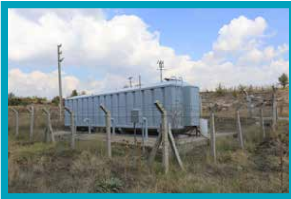
Çalıköy Paket Atıksu Arıtma Tesisi
