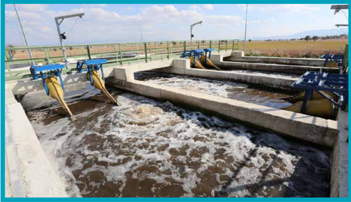
Serinhisar Atıksu Arıtma Tesisi
