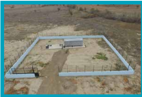
Çal Dayılar Paket Atıksu Arıtma Tesisi
