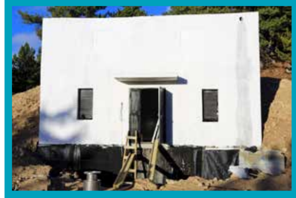
Çameli Kolak Yeni İçmesuyu Deposu
