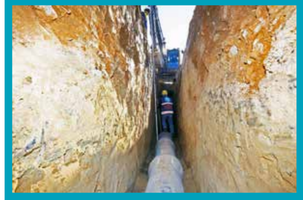
Çivril İlçesi Irgılı Mahallesi Kanalizasyon Hattı
