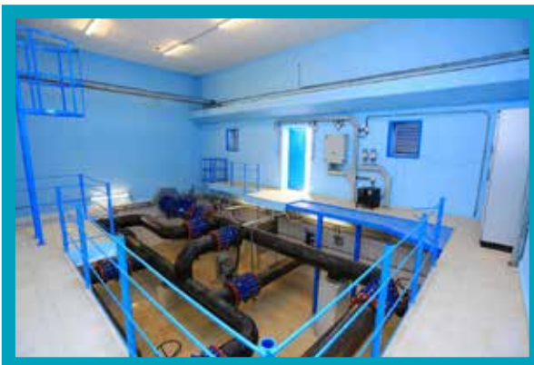
İçmesuyu Deposu Manevra Odası
