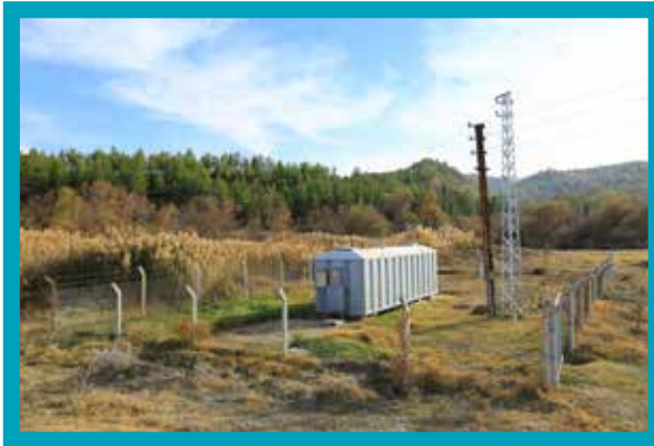
Köke Paket Atıksu Arıtma Tesisi
