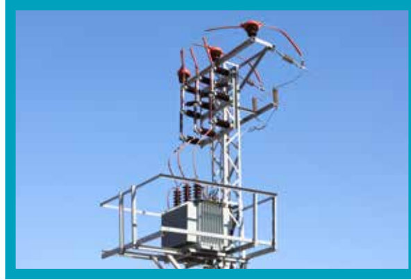
Trafolu Orta Gerilim Tesis
