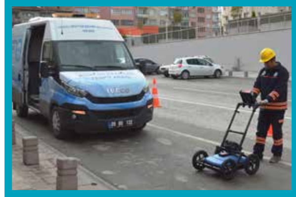
Topraklık Mahallesi Fiziki Kayıp – Kaçak Tespit Çalışmaları
