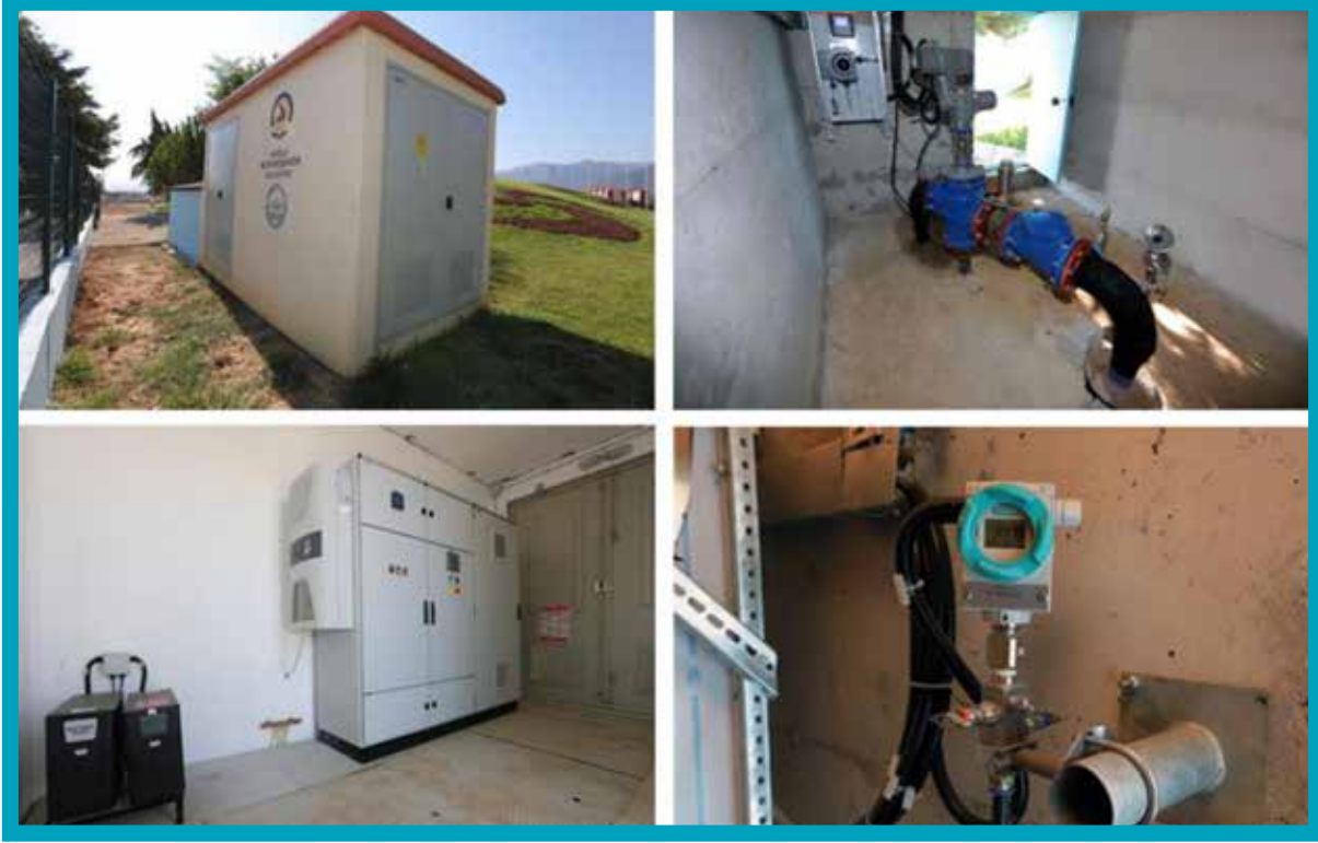
Zeytinköy Mahallesi SCADA Kontrollü Derin Kuyu Pompalarımız
