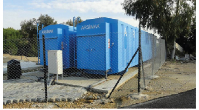
Şekil 16. Proje Onay Komisyonunca Onaylanan Tamamlanmış Bir Arıtma Tesisi
