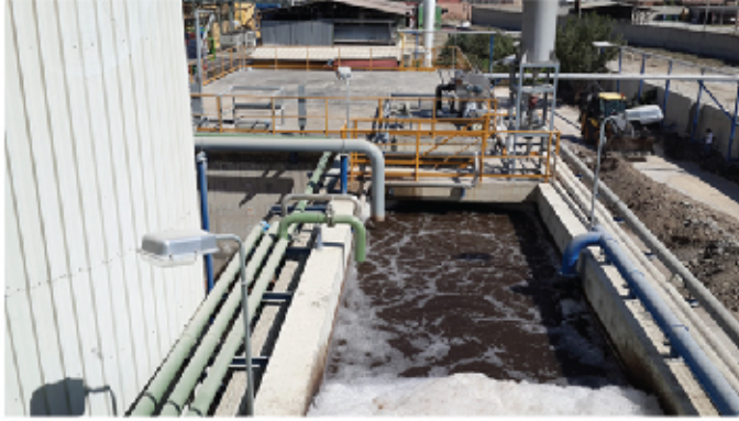
Şekil 15. Proje Onay Komisyonunca Onaylanan Tamamlanmış Bir Arıtma Tesisi
