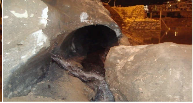
(Yağmur suyu çalışması)
