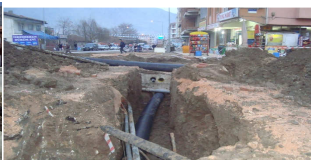
(Şeyhcui Mah. Kanalizasyon hat )
