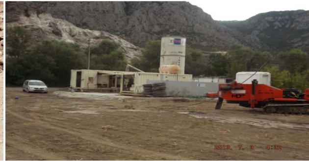
(Atıksu Arıtma Jetcraft)
