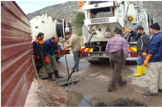
(Kanalizasyon kanal açma vidanjörü)
