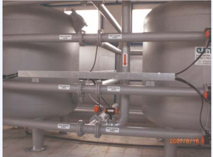
Kanlıçay İçmesuyu Arıtma Tesisi
