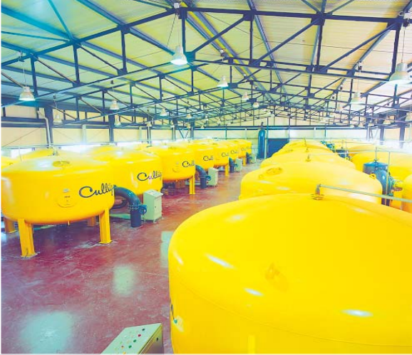
Maltepe İçmesuyu Arıtma Tesisi
