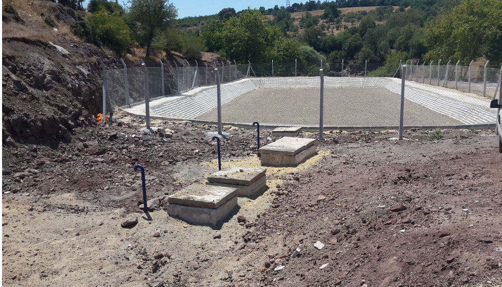
Atıksu Doğal Arıtma
