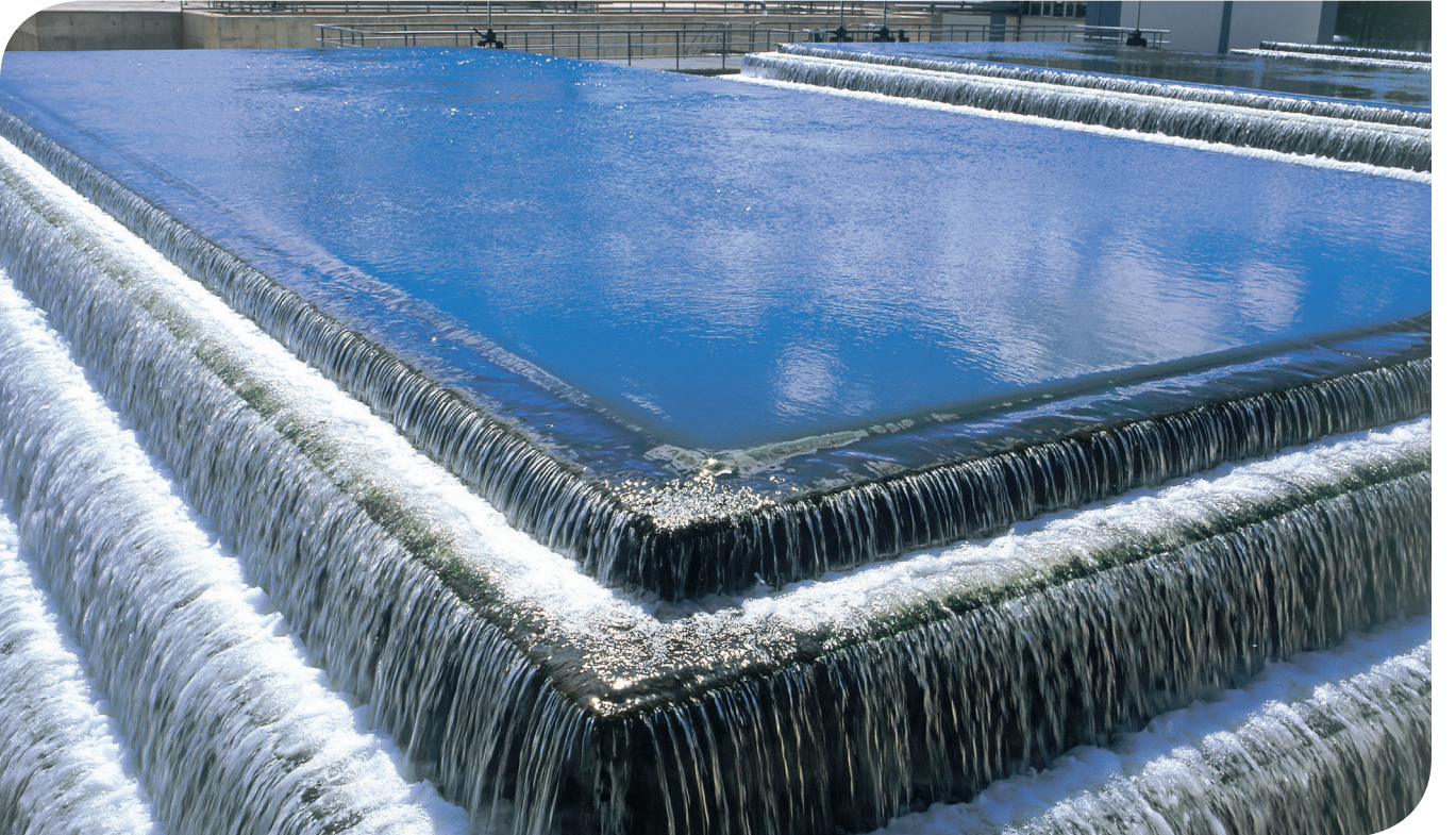
Ömerli İçmesuyu Arıtma Tesisi Havalandırma Ünitesi
