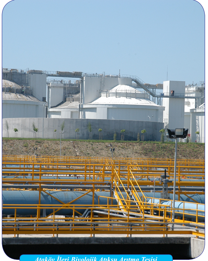
Ataköy İleri Biyolojik Atıksu Arıtma Tesisi
