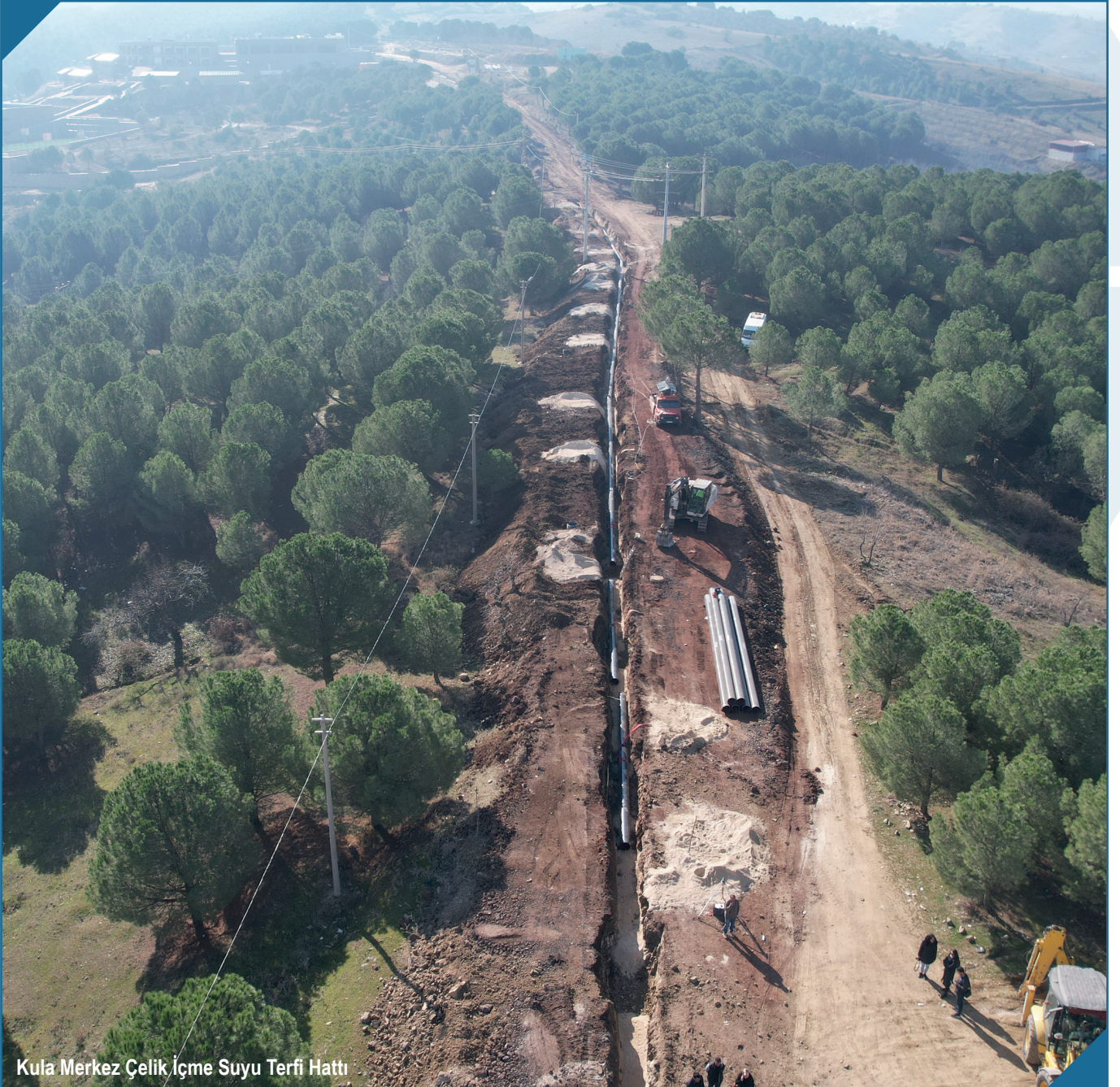
Kula Merkez Çelik İçme Suyu Terfi Hattı ve İçme Suyu Deposu
