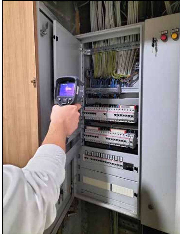
Şekil 15: İç Elektrik Tesisatı ve Topraklama Periyodik Muayeneler
