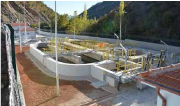
Saimbeyli Atıksu Arıtma Tesisi
