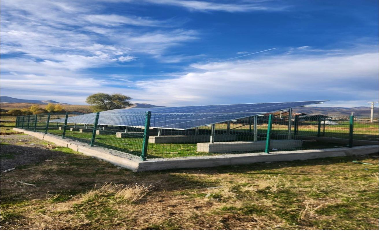
Merkez Yelalan Köyü Güneş Enerjili İçme Suyu Tesisi Yapım İşi
