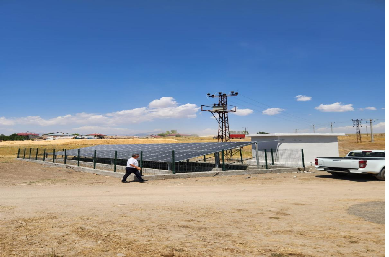
Bulanık Cankurtaran Köyü Güneş Enerjili İçme Suyu Tesisi Yapım İş
