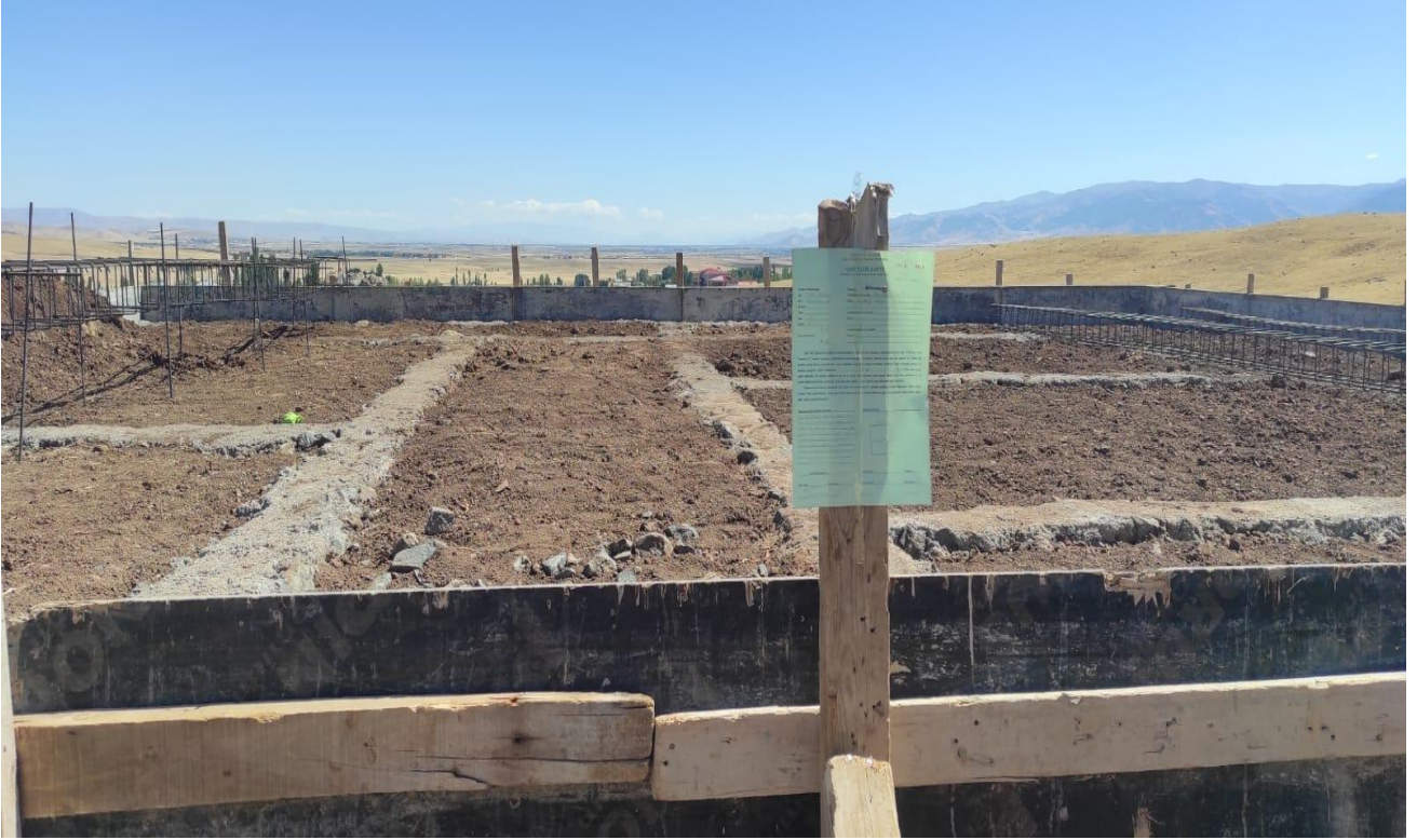
Kaçak yapı tespiti yapılan yapı
