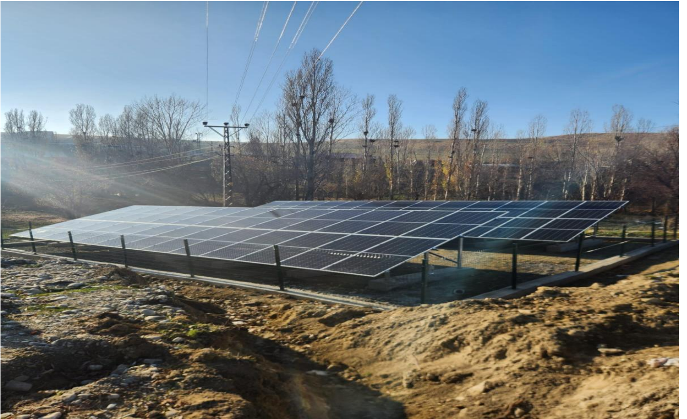
Bulanık Akçaarmut Köyü Güneş Enerjili İçme Suyu Tesisi Yapım İşi
