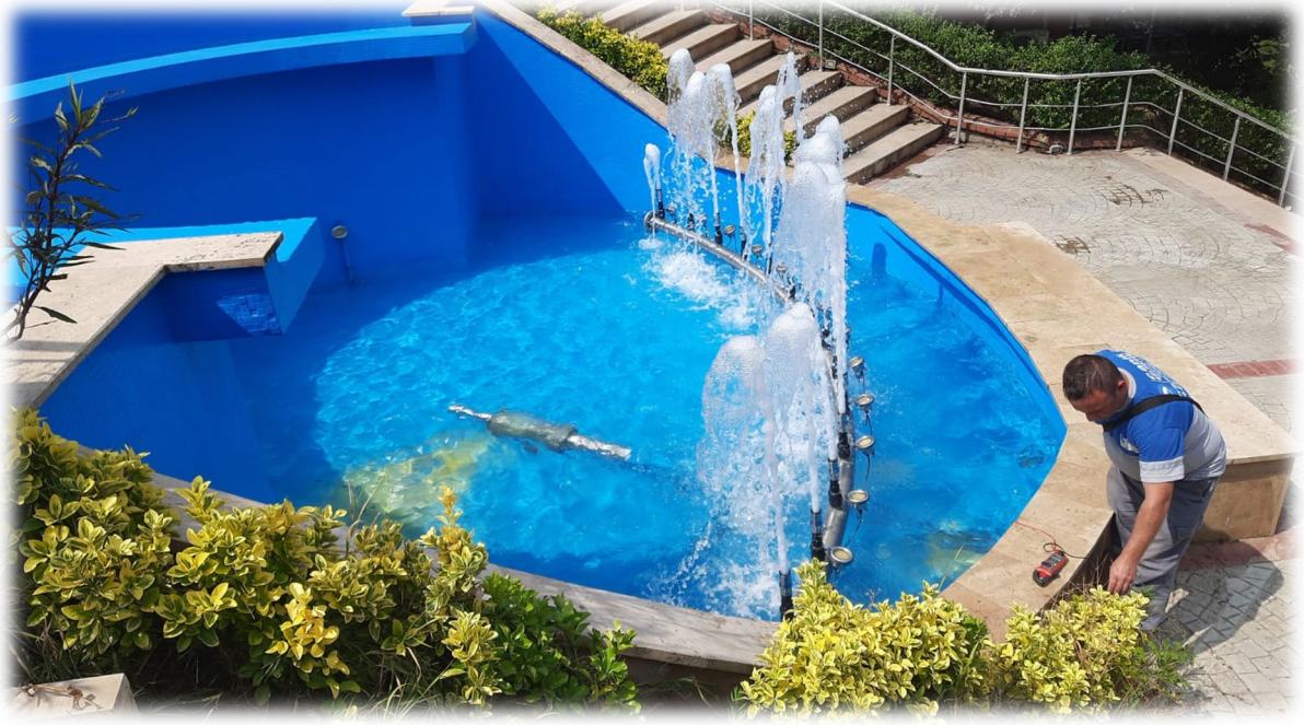
MEŞE TESİSLERİ HAVUZ ELEKTRİK TESİSATI BAKIMI
