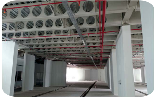
Resim 2: Kapalı Pazar Yeri Elektrik Tesisatı
