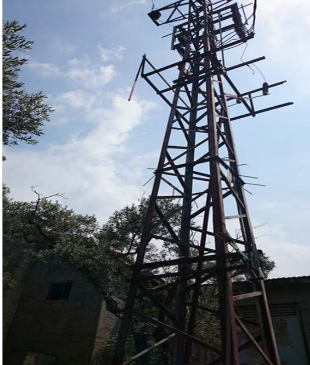
Resim 11: Umurbey Zeytin Sulama Havuzu direk tipi trafo
