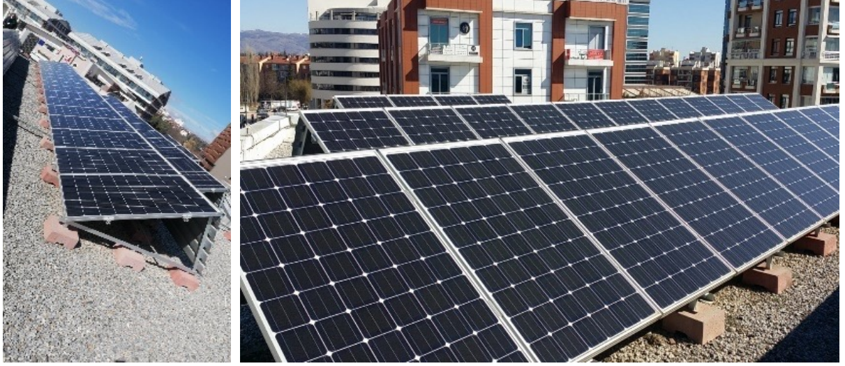
Resim 32. Belediye binası güneş panelleri
