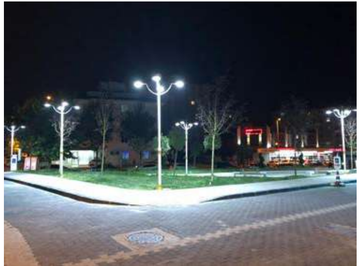
FİSİLTİ PARK AYDINLATMA ÇALIŞMASI
