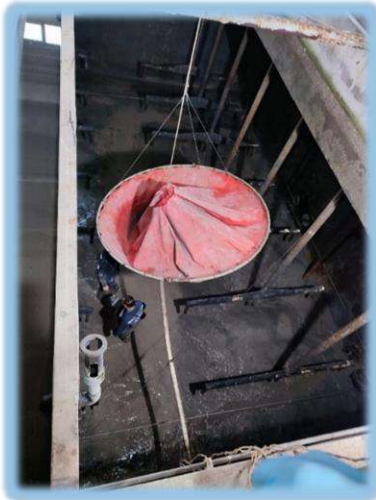
Durultucu Ünitesi Bakım İşi
