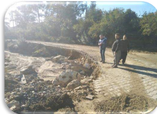
MURATLI MAHALLESİ AFET SONRASI KONTROL
