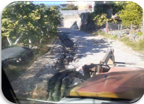
KAKLIKTAŞI MAHALLESİ AFET SONRASI KONTROL
