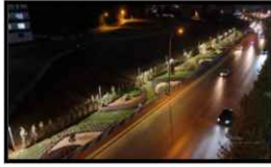
Yeşilova Kavşağı Şev Alanı Aydınlatma
