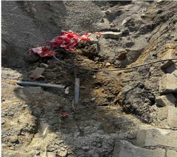
Altyapı çalışmalarında zarar gören kablolar için ek mufu yapıldı.
