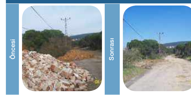
Tespiti Yapılan Kaçak Dökümlerden Görünüm
