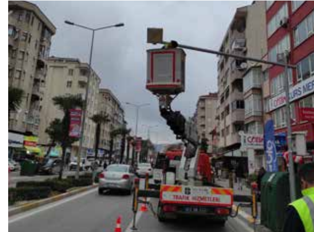
Gazi Bulvarı (Etiket Okuyucu Bakım, Onarım Çalışması)
