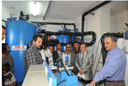
Oyaca ve İkizce'ye Su Sağlayan Arıtma Tesis
