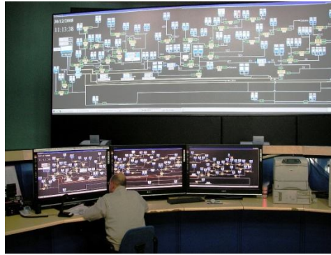
ASKİ SCADA Kontrol Merkezi
