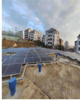
S.PAŞA 5.000 M3 DEPO GES (60 Kw)
