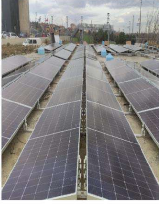
S.PAŞA 2.500 M3 DEPO GES (60 Kw)
