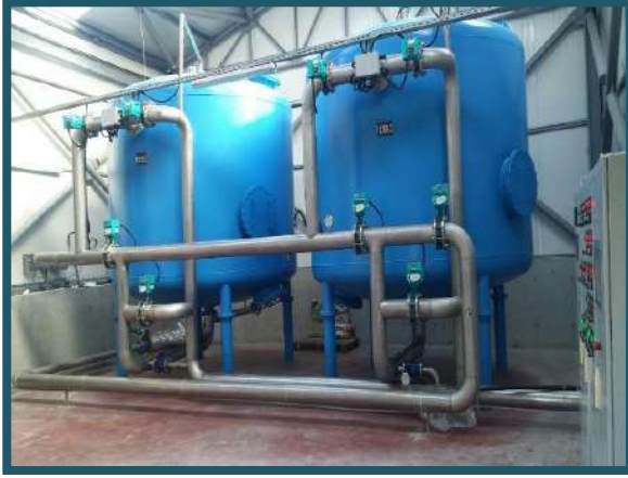
Kum Filtre ve Demir-Mangan Giderim Tankları
