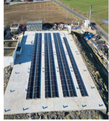
S.PAŞA 10.000 M3 DEPO GES (140 Kw)
