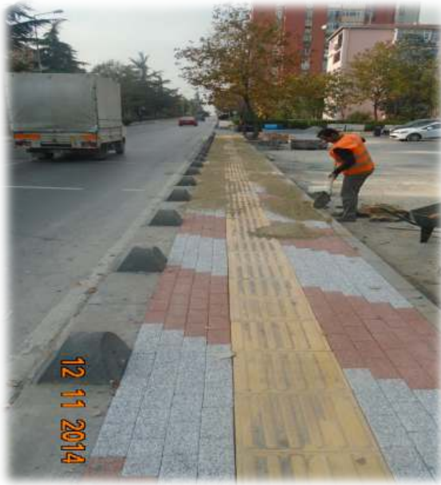
Parke Taş-Beton Kaplama D şenmesi G rsel
