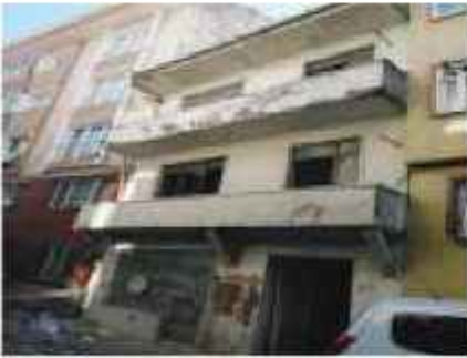
22194 Sayılı Parseldeki Riskli Bina
