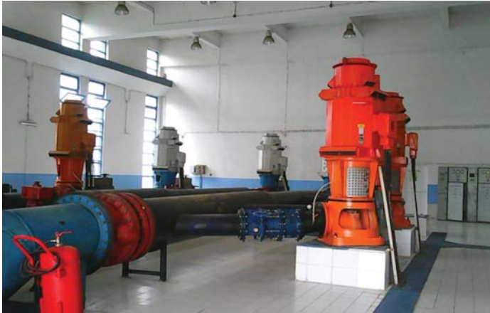
Porsuk İçmesuyu Tesisinde Çalışan Pompalarımızın Görüntüsü
