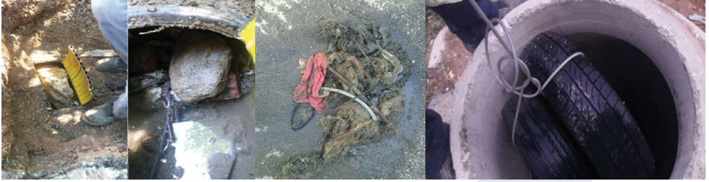
Kanalizasyon şebeke hatlarımızda çıkan malzemeler
