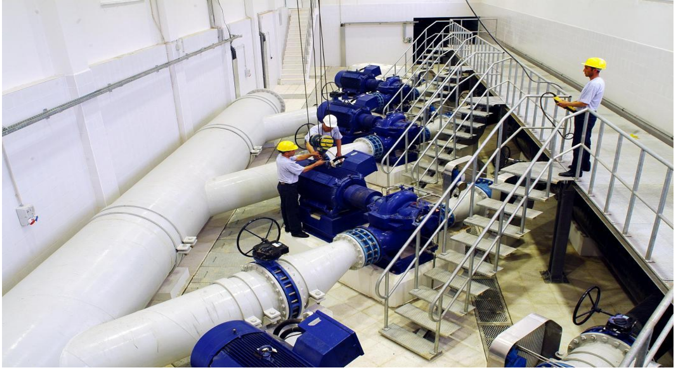
Çatalan Arıtma Tesisleri Pompa Odası
