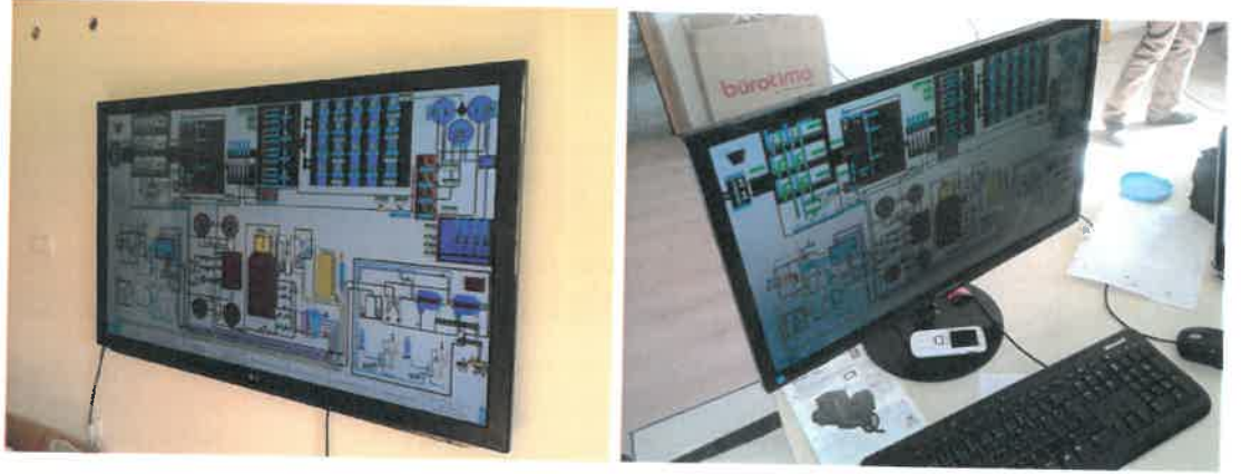
(Scada İzleme ve Kontrol)
