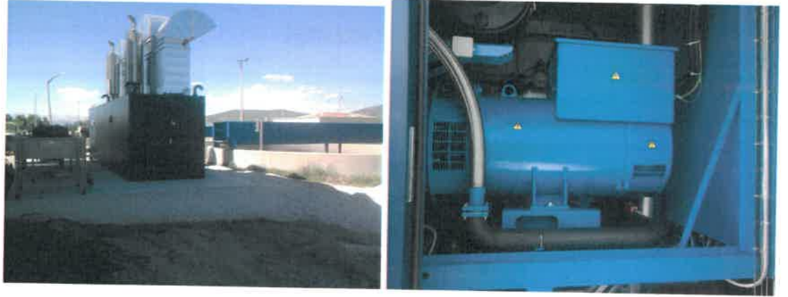
(Biyogaz Jeneratör Ünitesi)
