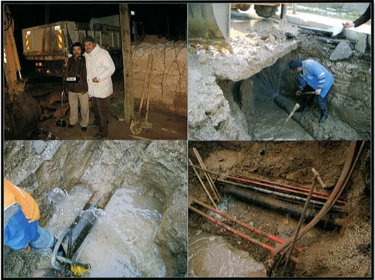
İçme Suyu Şebekesi Üzerinde Tespit Edilmiş Bazı Su Kaçağı Görüntüleri
