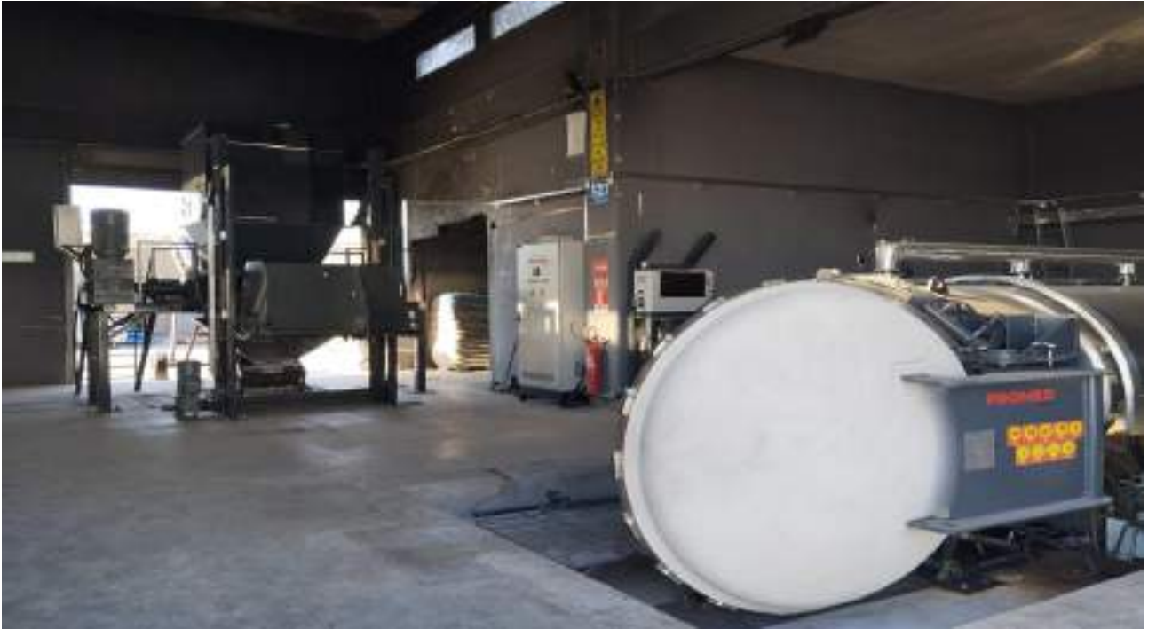
Tıbbi Atık Sterilizasyon Tesisi
