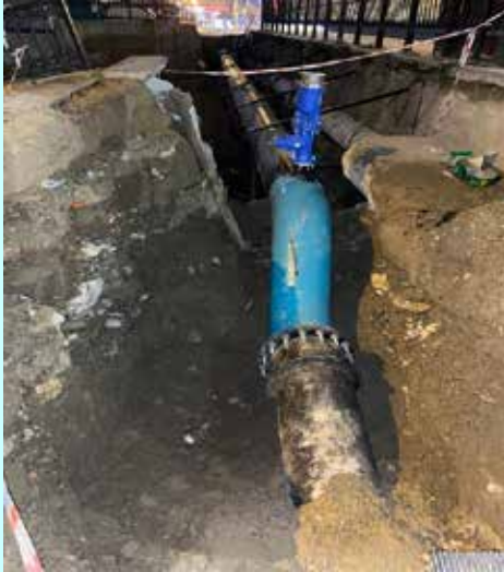
AKŞEHİR MEYDAN MH. SU ŞEBEKE HATTI ARIZASI
