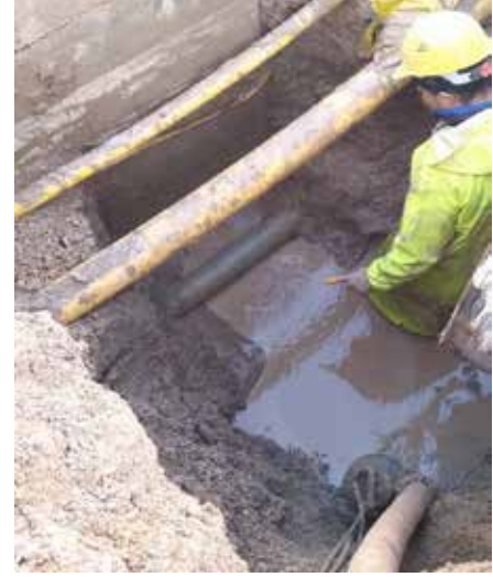
ÇUMRA BARAJ MH. SU ŞEBEKE HATTI ARIZASI
