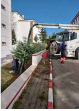
BEYŞEHİR BADEMLİ MH. KANAL ŞEBEKE ARIZASININ GİDERİLMESİ
