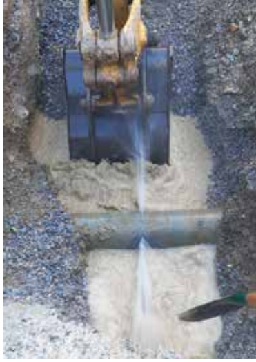
AKŞEHİR SEYRAN MH. SU ŞEBEKE HATTI ARIZASI
