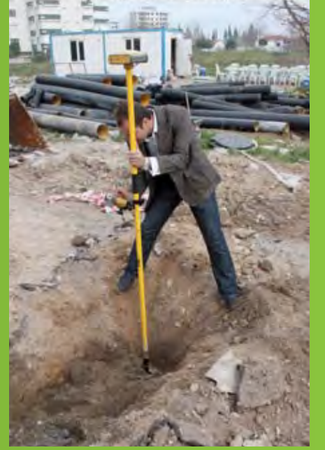
İçmesuyu Şebekesi Vana Ölçümü
