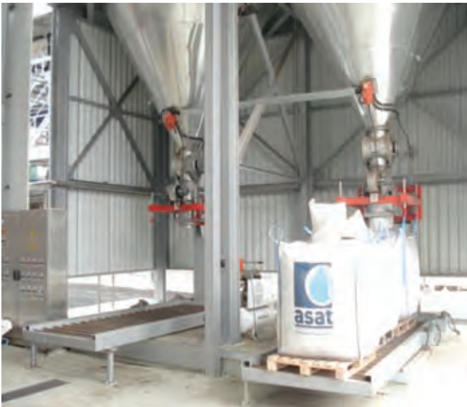
Arıtma Çamuru Termal Kurutma Tesisi / Nihai Ürün Dolum Noktası
