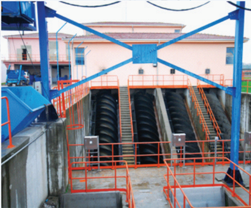
Giriş Pompa İstasyonu
