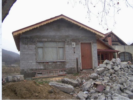
Aşağıdereköy mevkiinde tespit edilen kaçak yapı
