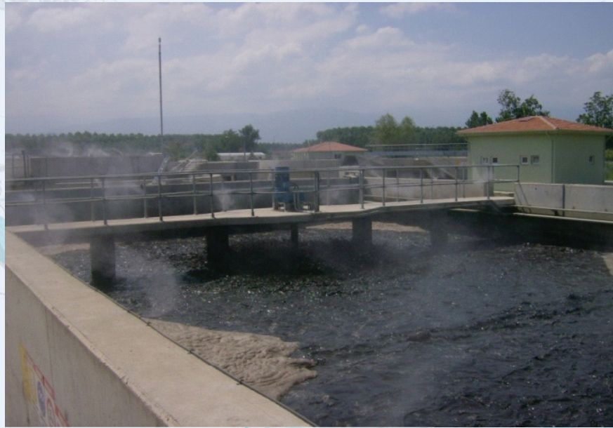
Akyazı Atıksu Arıtma Tesisi
