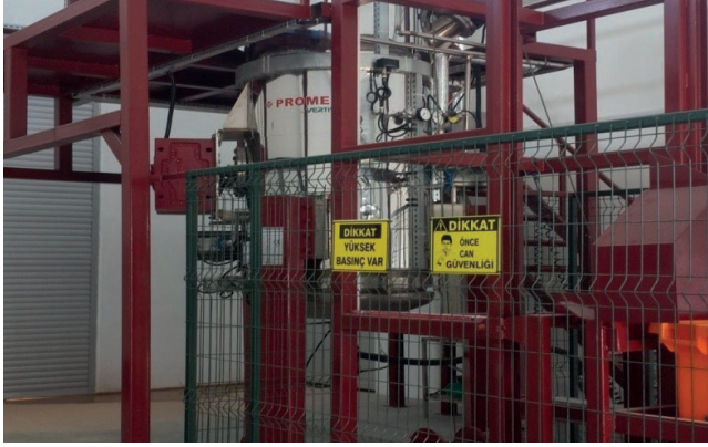
Şekil 2.1 Tıbbi Atık Sterilizasyon Tesisisi
