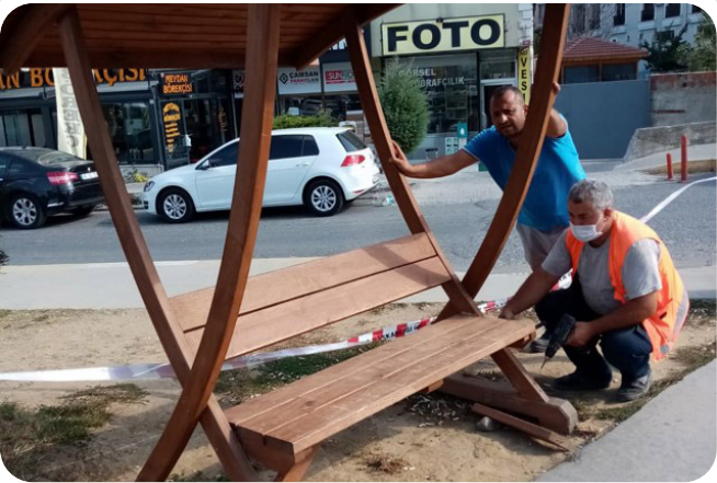
*633 ADET BANK YERLEŞTİRİLMESİ - PARK VE BAHÇELER MD.
