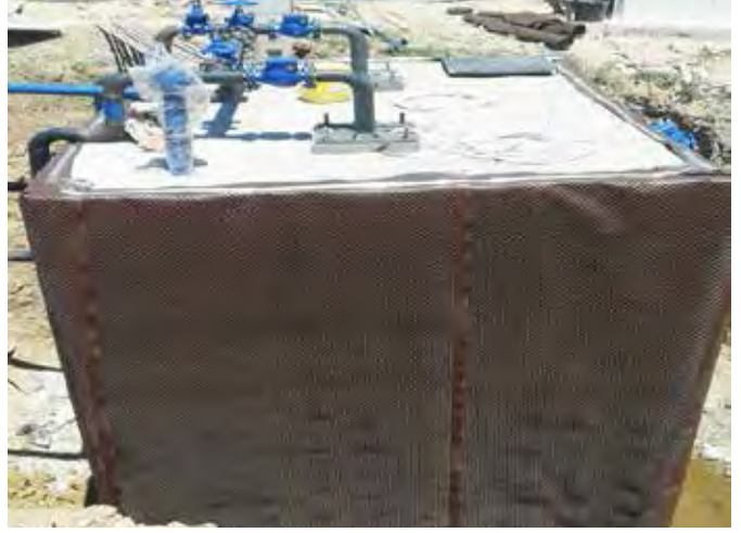
TERFİ MERKEZİ YAPILMASI İLE İLGİLİ ÖRNEK RESİMLER BOZKIR ÇAĞLAYAN TERFİ MERKEZİ
