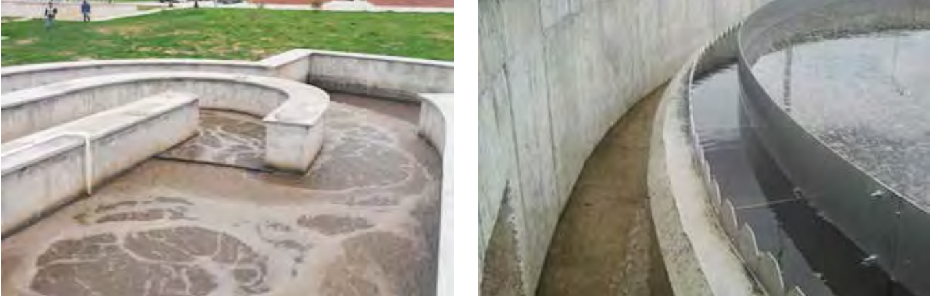
Fotoğraf 10. Yunak Atıksu Arıtma Tesisi
