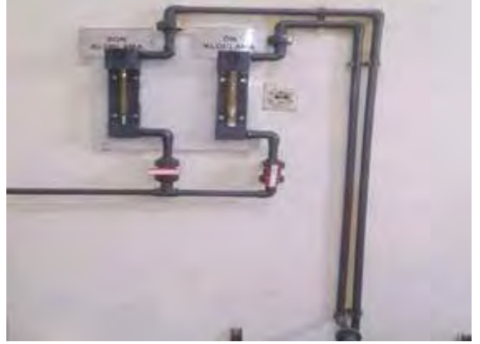
RESİM 2.BEYŞEHİR ART.TES.GAZ KLORLAMA YENİ HALİ.
