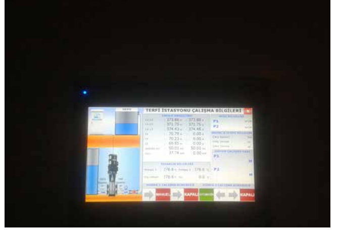
TEPEKENT TERFİ SCADA PANOSU
