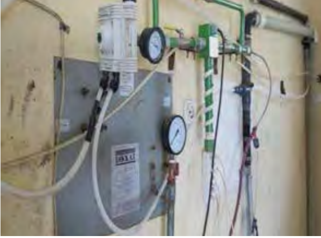
RESİM 1.BEYŞEHİR ART.TES.GAZ KLORLAMA ESKİ HALİ.
