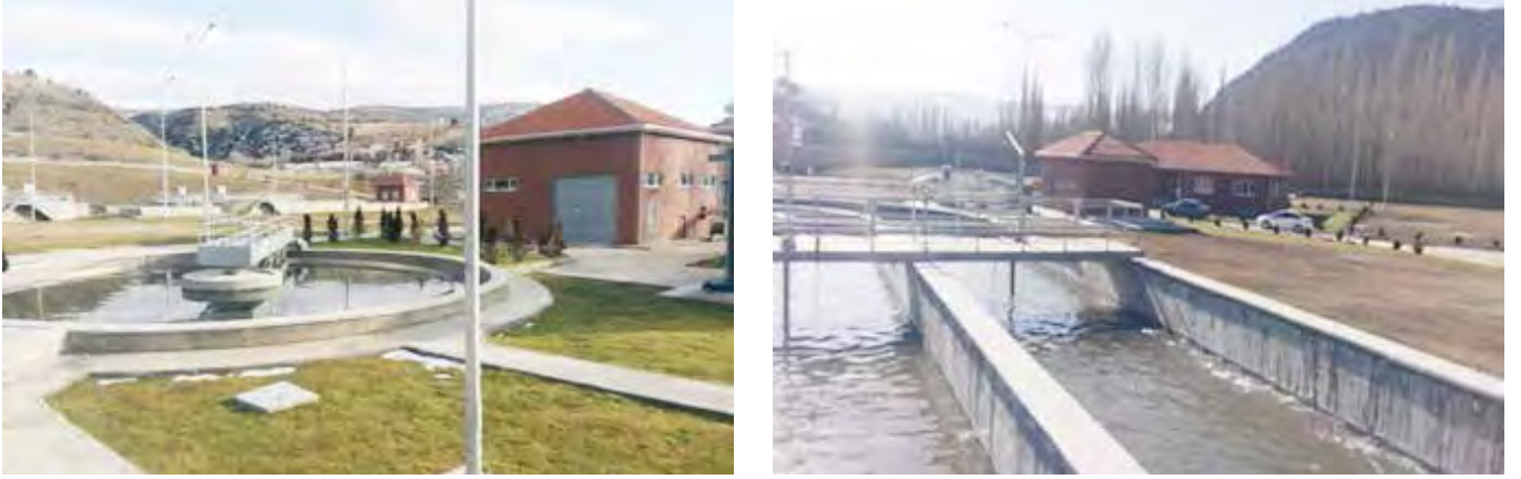
Fotoğraf 9. Bozkır Atıksu Arıtma Tesisi
