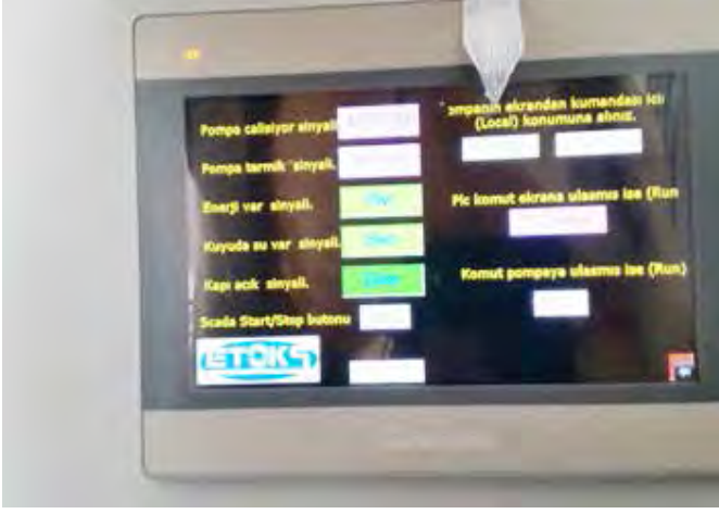
KULU-KARACABEY İÇME SUYU ARITMA TESİSİ SCADA SİSTEMİ
