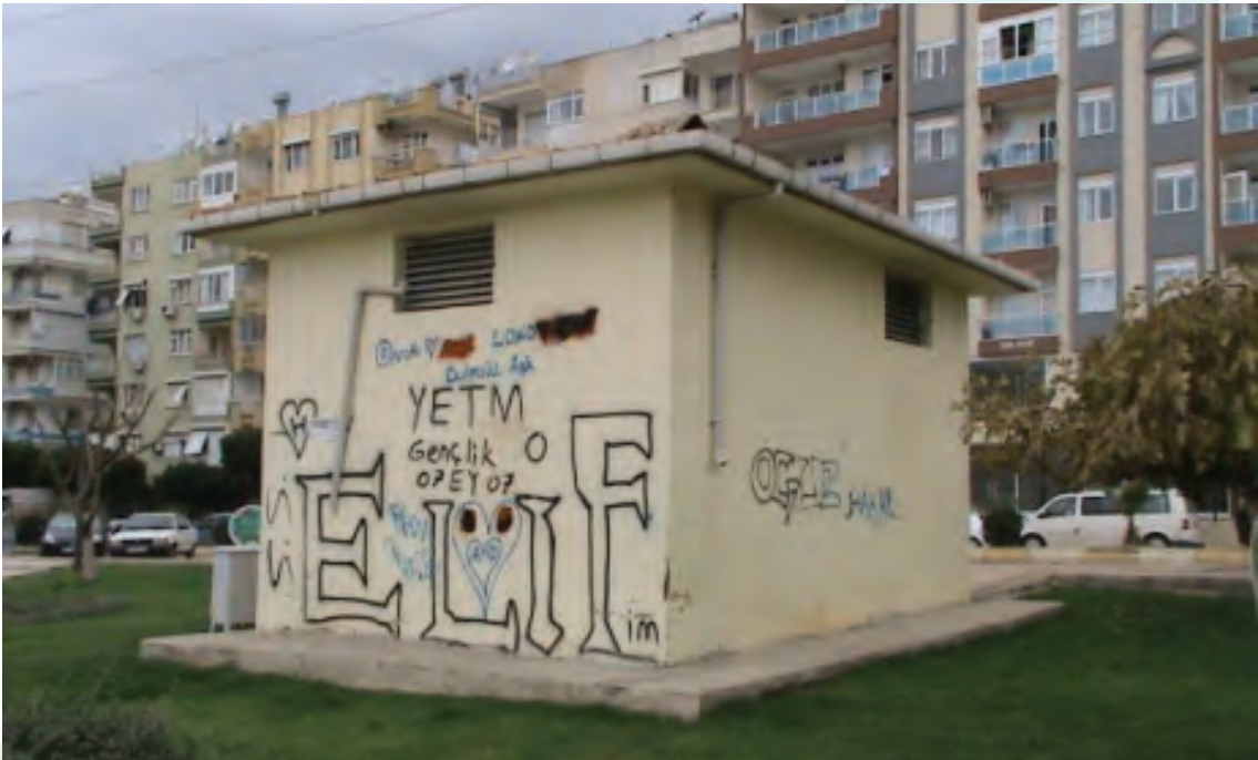
❖ Trafonun Eski Hali
