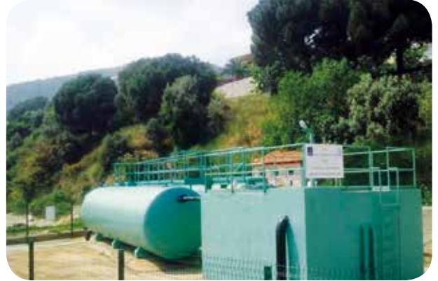
Narlı Paket Atık Su Arıtma Tesis
