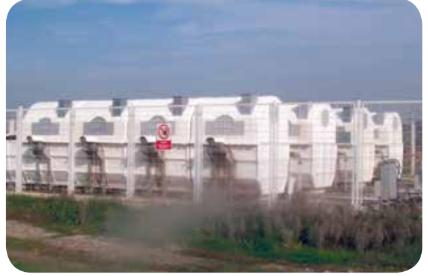
Hasanağa Paket Atık Su Arıtma Tesisi
