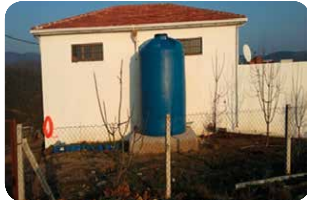
Karacabey İçmesuyu Arıtma Tesisi
