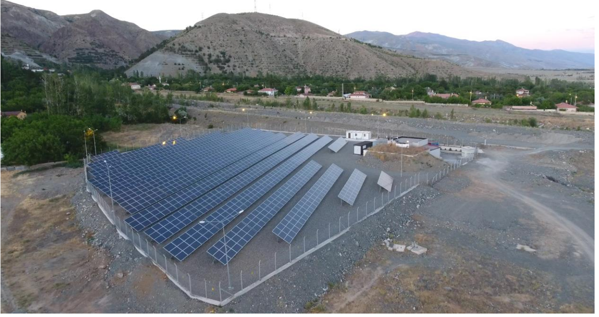
Resim 11: Güneş Enerjisini Destekleme Projesi-Kavakyolu GES (Erzincan)
