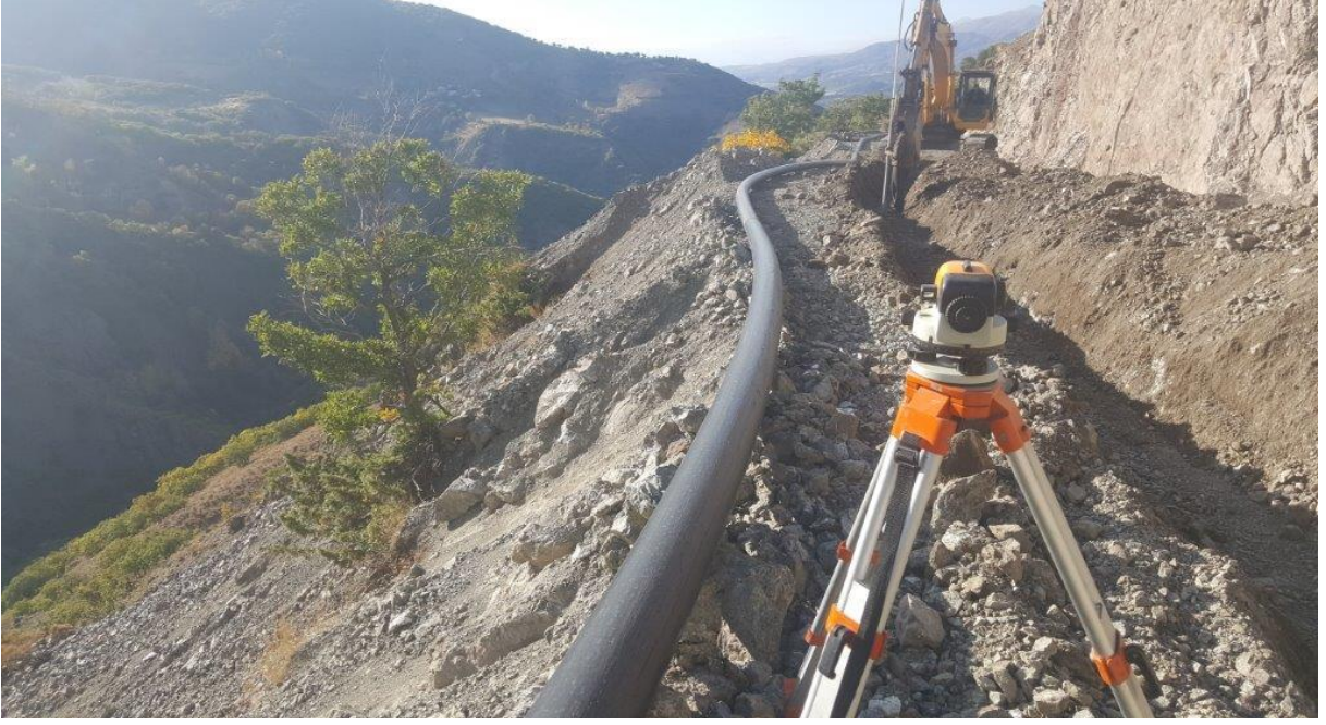
Resim 13: KÖTS Projesi Ünveren Köyü-Pülümür (Tunceli)
