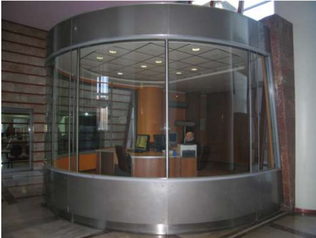
KASKİ SCADA MERKEZİ
