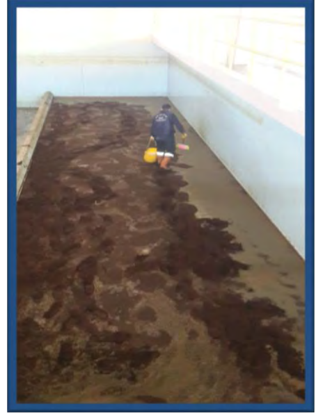
Filtre Havuz Temizliği
