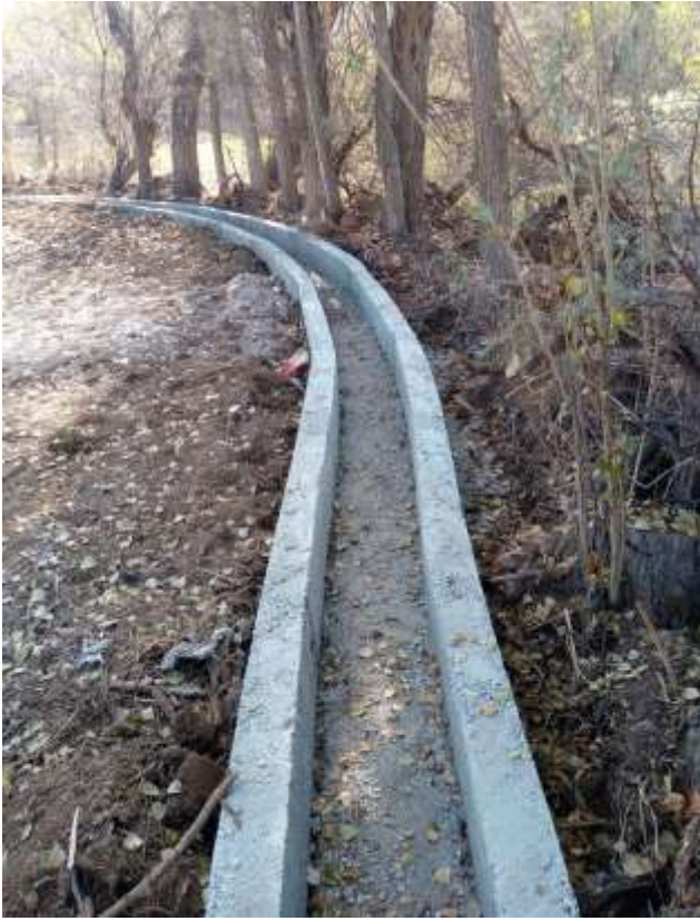
Kelkit Babakonağı Sulama Tesisi
