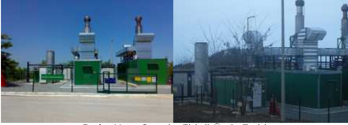
Resim: Metan Gazından Elektrik Üretim Tesisi
