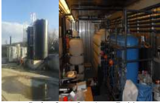
Resim : Sızıntı Suyu Arıtma Tesisi
