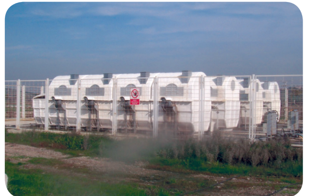
Hasanağa Paket Atık Su Arıtma Tesisi
