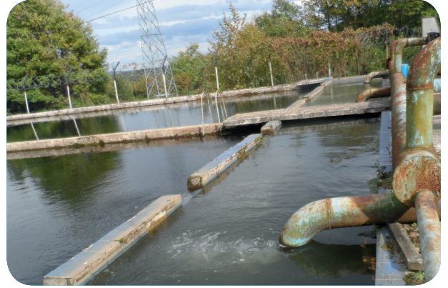
İçmesuyu Arıtma Tesis
