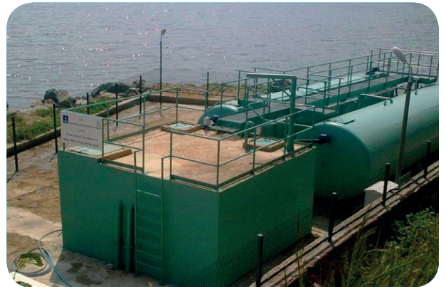
İçmesuyu Arıtma Tesis
