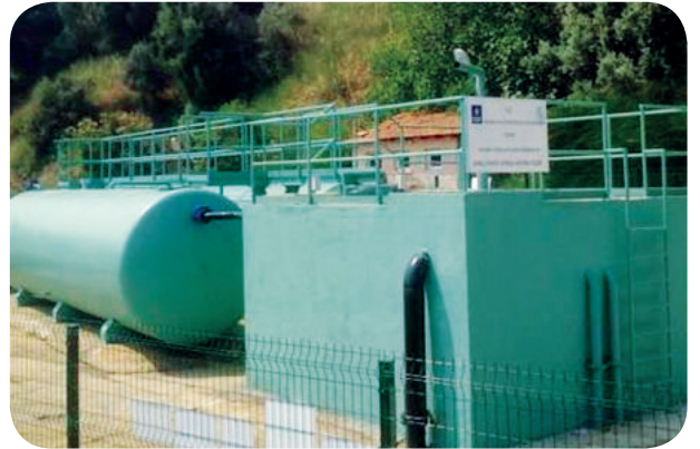
Narlı Paket Atık Su Arıtma Tesis
