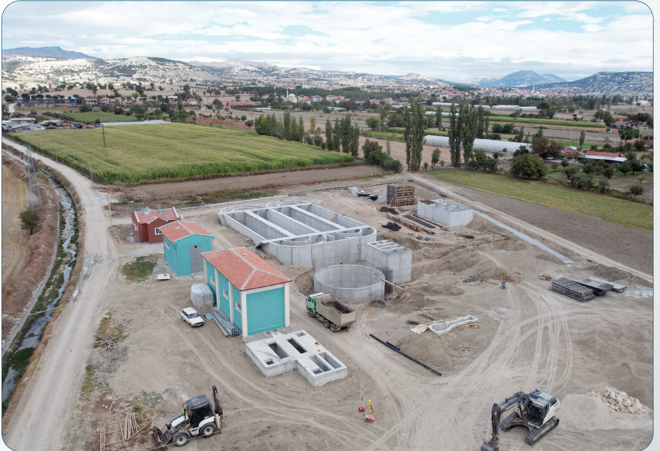
Selendi Atıksu Arıtma Tesisi
