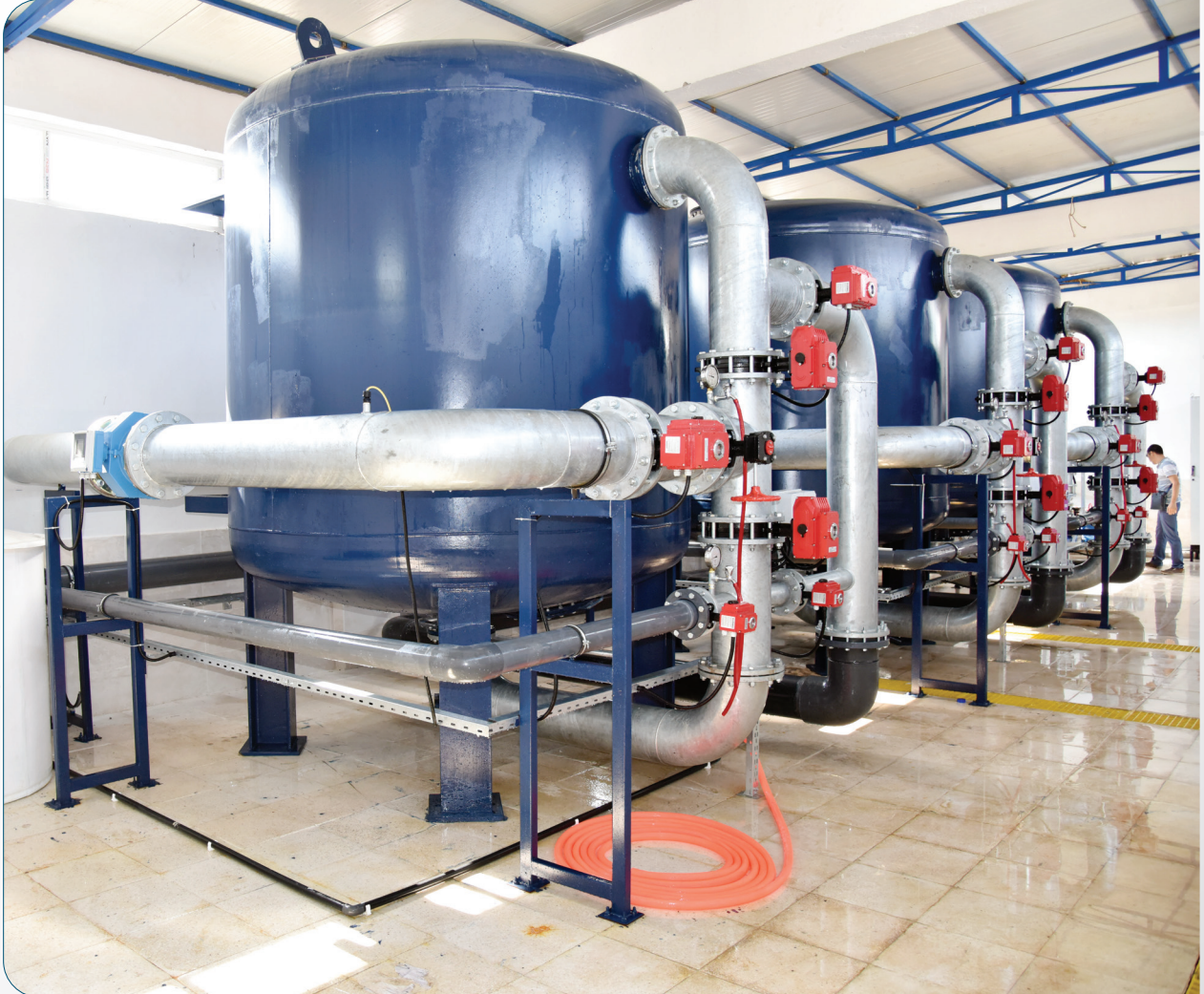
Saruhanlı Merkez İçme Suyu Arıtma Tesisi
