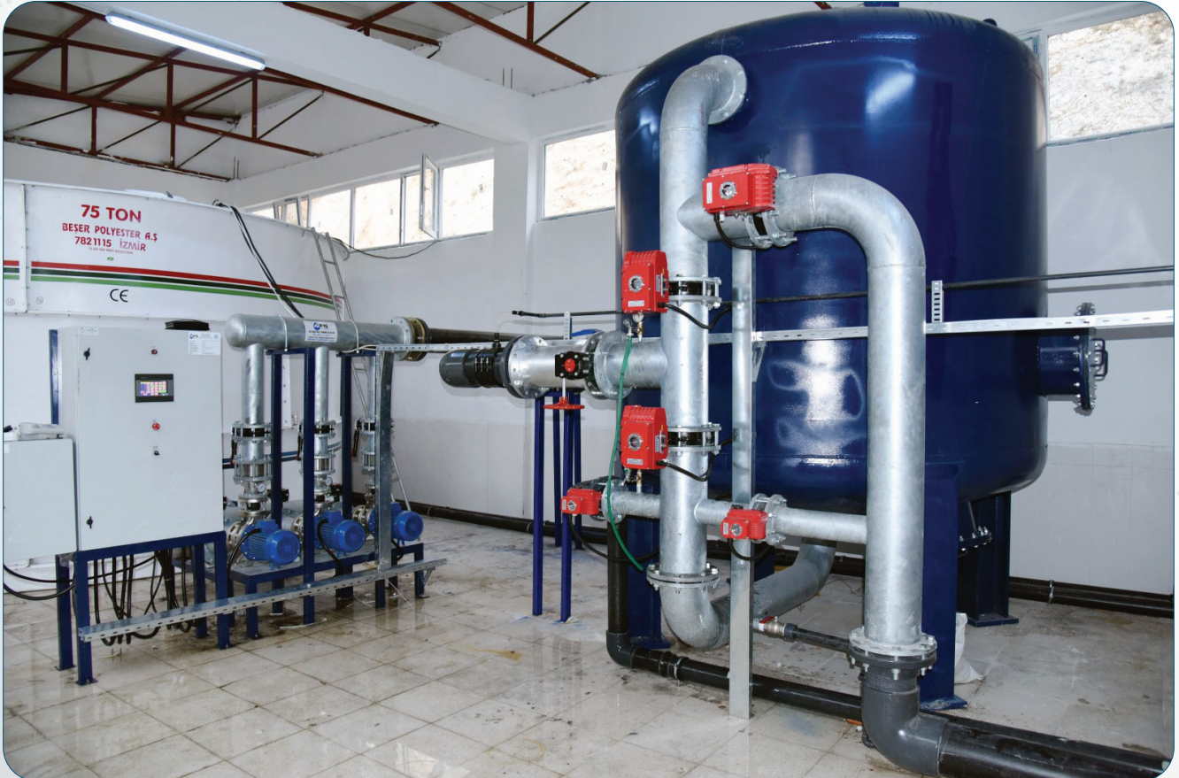
Kırkağaç Bakır Mahallesi İçme Suyu Arıtma Tesisi
