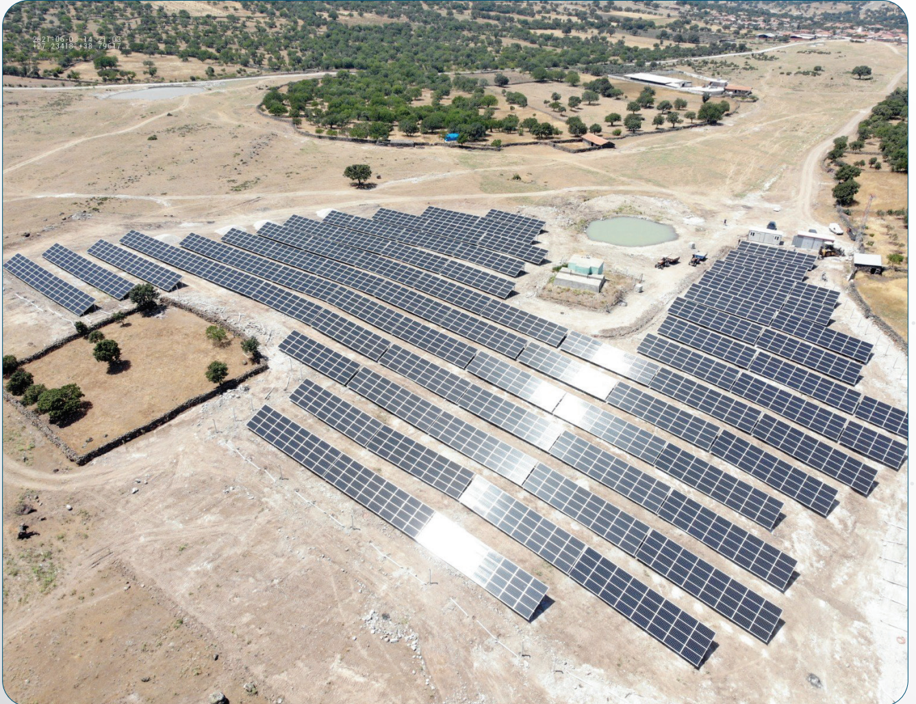
Yunusemre Seyitli Güneş Enerji Santrali
