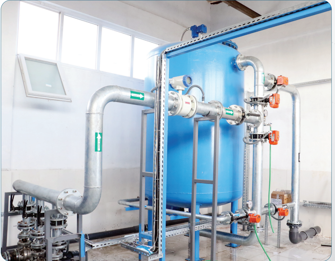
Saruhanlı İshakçelebi Mahallesi İçme Suyu Arıtma Tesisi
