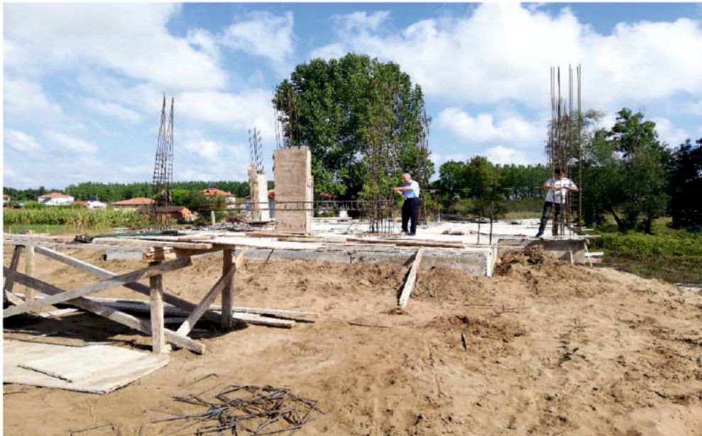
Ruhsatsız İnşaat Örneği
