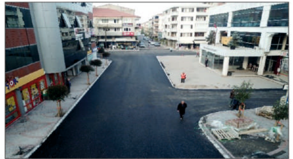
İncilli Mahallesi 620 Nolu Sokak Belediye Önü
