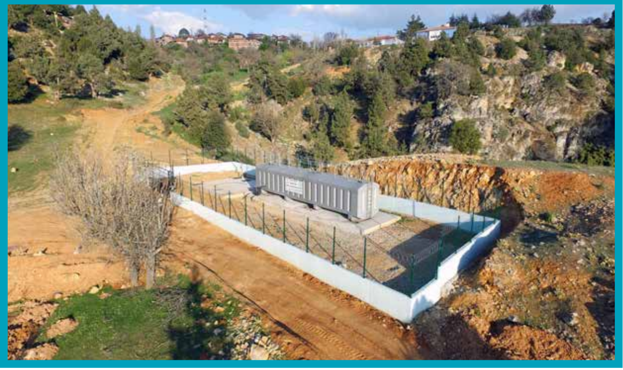
Acipayam Eskiköy Paket Atıksu Arıtma Tesisi
