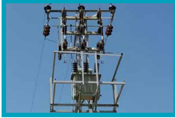
Orta Gerilim Trafo Arızası
