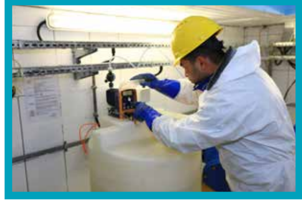
İçmesuyu Deposu Klor Cihazı Dozaj Ayarlanması
