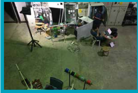
Elektrik Arıza Ekibinin Pano Çalışması
