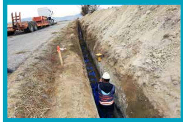
1. Bölge Çivril, Somak, Beyelli Grup İçmesuyu Kontrol Ölçümü
