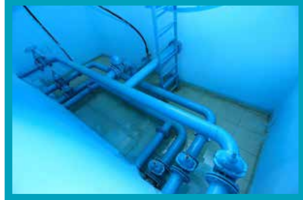
Çameli Yılcık Depo Mekanik Odası Yeni Hali
