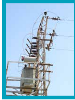
Ayırıcı Kolu İndirilerek Direkten Enerjinin Kesilmesi-Sonrası
