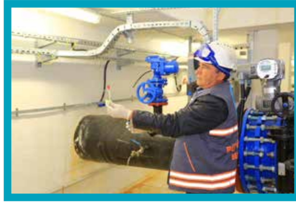
İçmesuyu Deposu Şebeke Çıkışı Bakiye Klor Kontrolü
