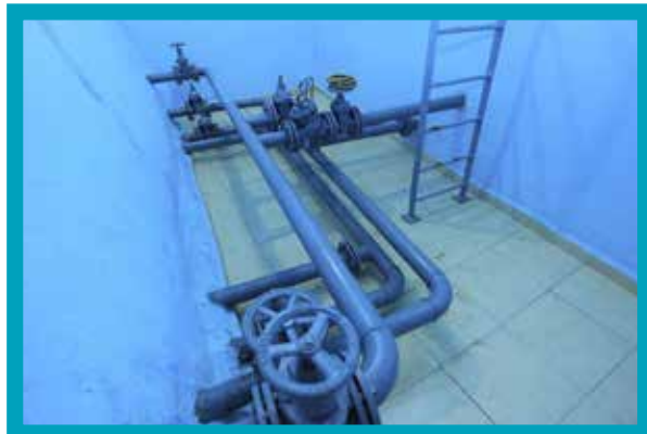
Bozkurt İncelertekkesi Mekanik Aksam Yeni Hali
