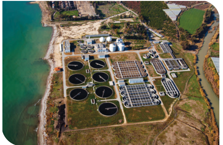
Karaduvar Atıksu Arıtma Tesisi
